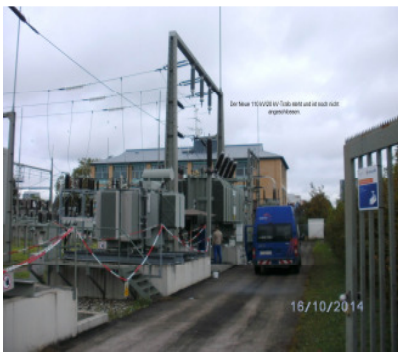
Der neue 110 kV Trafo steht und wird von den badenova Techniker angeschlossen.
